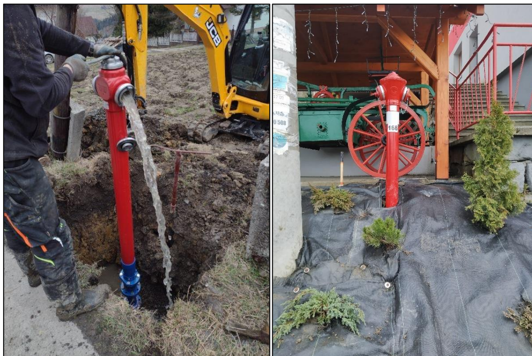
Fotografia 5.1.3 Z lewej: nowy hydrant w okolicy OSP Koniaków Centrum; Z prawej: nowy hydrant w okolicy OSP Jaworzynka Centrum
