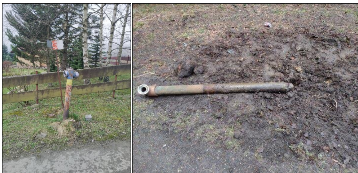
Fotografia 5.1.4 Z lewej: strony uszkodzony hydrant Jaworzynka Czepczory; Z prawej: strony uszkodzony hydrant Istebna Wilcze
