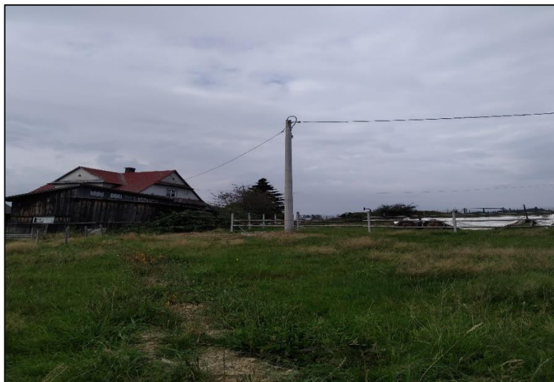
Fotografia 5.1.6 Przystawiony słup niskiego napięcia – Istebna Jasnowice
