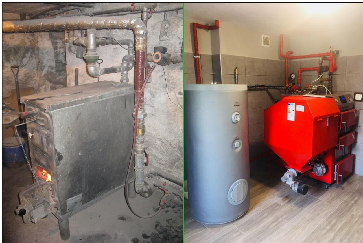
Fotografia 155.8 Kotłownia przed modernizacją oraz po modernizacji
